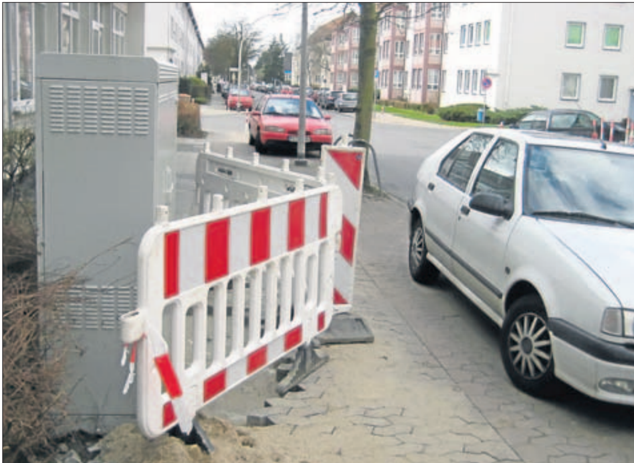
Tuckermannstraße: Entlang des von Baken umzäunten Schaltschanks gab es monatelang für Senioren mit Rollatoren und Rollstühlen kein Durchkommen. Foto: privat
